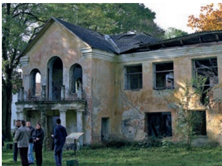
ZNISZCZONE SKRZYDŁO PAŁACU
